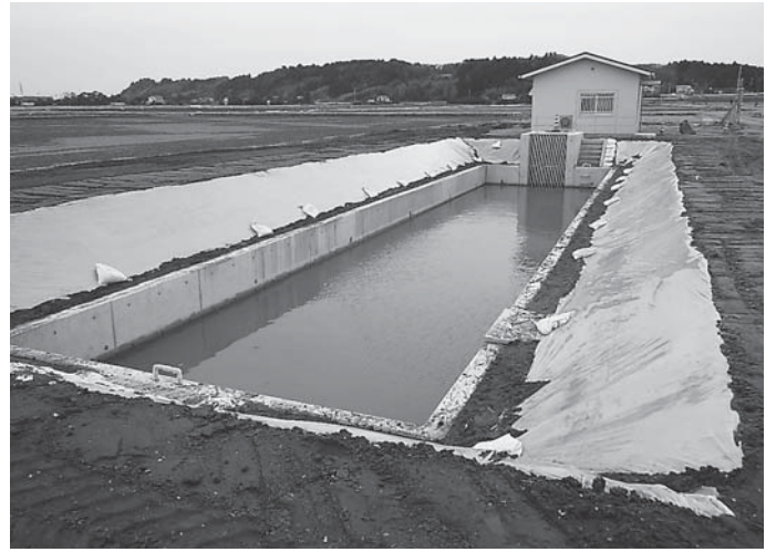
椿海地区 (第2揚水機場)
