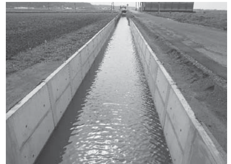
地域農業水利施設ストックマネジメント事業 (夏目地区幹線排水路護岸補修工事)
