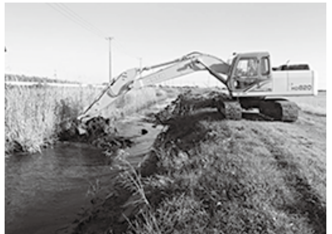
ロングアームバックホーによる浚渫作業 秋田川排水路（令和3年11月26日撮影）
